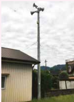
▲スピーカー（上町公民館敷地内）
