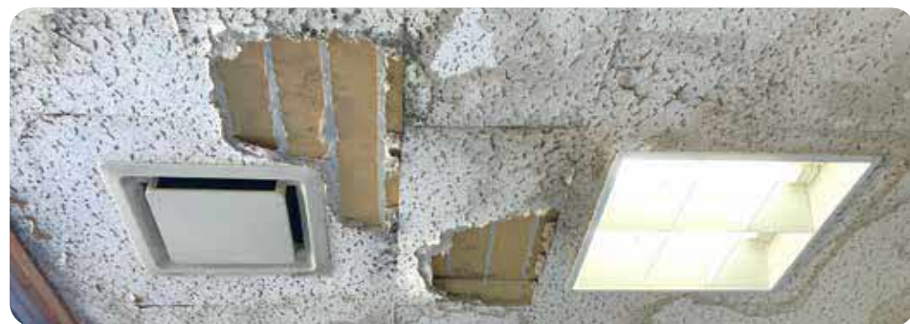
町民体育館雨漏り箇所
